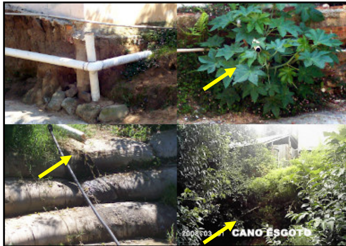
FIGURA 5 – ESGOTOS DOMICILIARES LANÇADOS NO RIO
