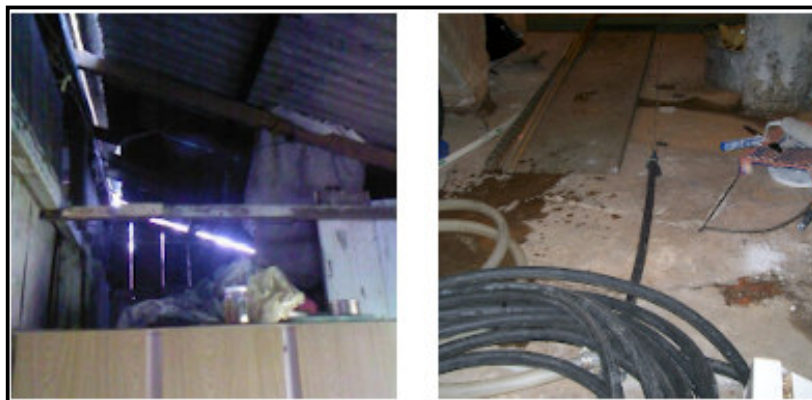
FIGURA 9 – TELHADO SEM FORRO E PISO
